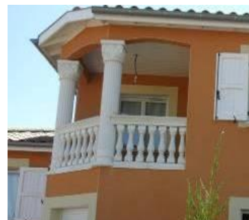
Type de balustres interdits
